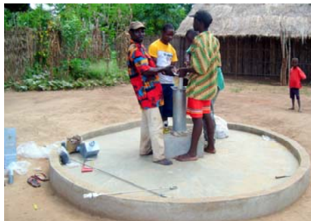
Miembros del CAS de Campine realizando mantenimiento preventivo a la fuente de la aldea
